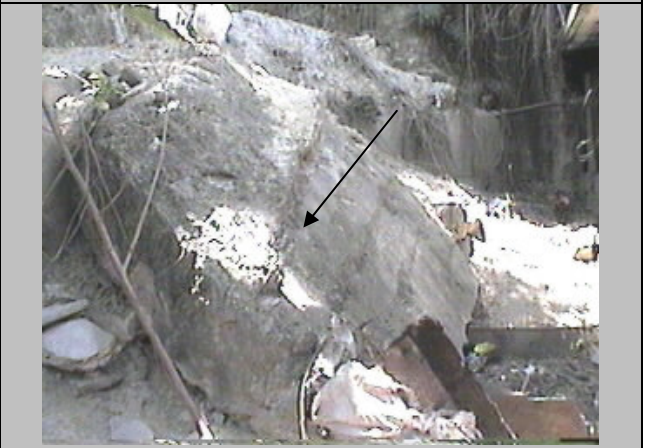
Cont. de la secuencia. Observe el muro, derrumbado en un aguacero, qué protegía la casa, en época de lluvia se desprenden pedazos de rocas. En una ocasión se hubieron de sacar 3 camiones de tierra del patio.
