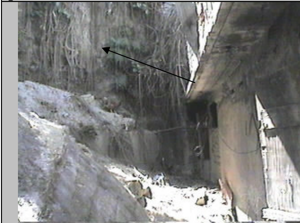
Casa construida al lado de un talud vertical en roca margosa, de la Fm La cruz, donde se producen derrumbes en época de fuertes lluvias. Continuación de la secuencia
